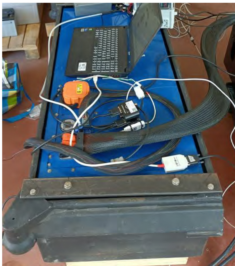
Figura 32. Alloggiamento della batteria ad alta tensione nel primo convertitore.
