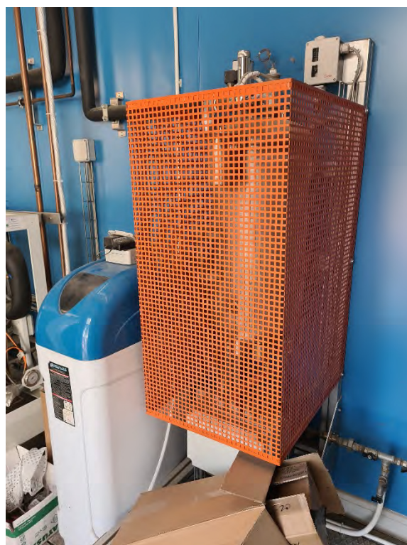
Figura 6: Generatore di vapore e addolcitore d'acqua.
