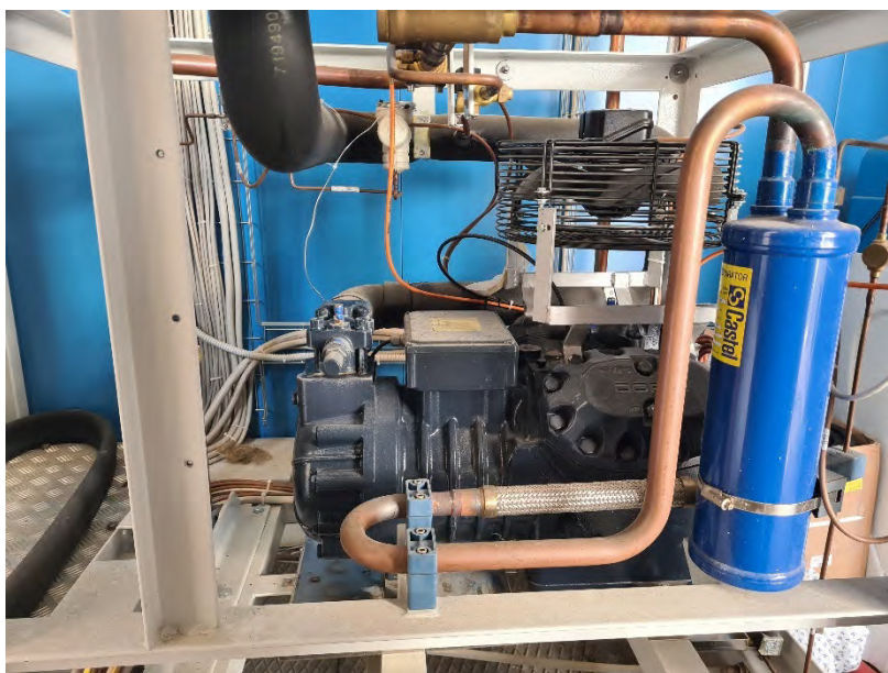
Figura 5: Sistema frigorifero Calorimetro Enea.
