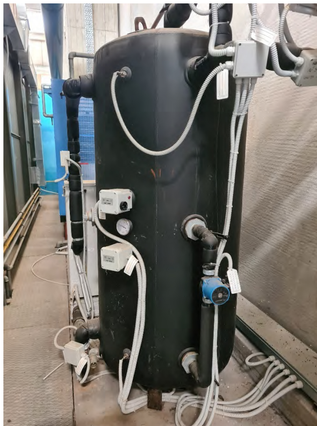
Figura 8: Serbatoio d'accumulo con resistenze elettriche.
