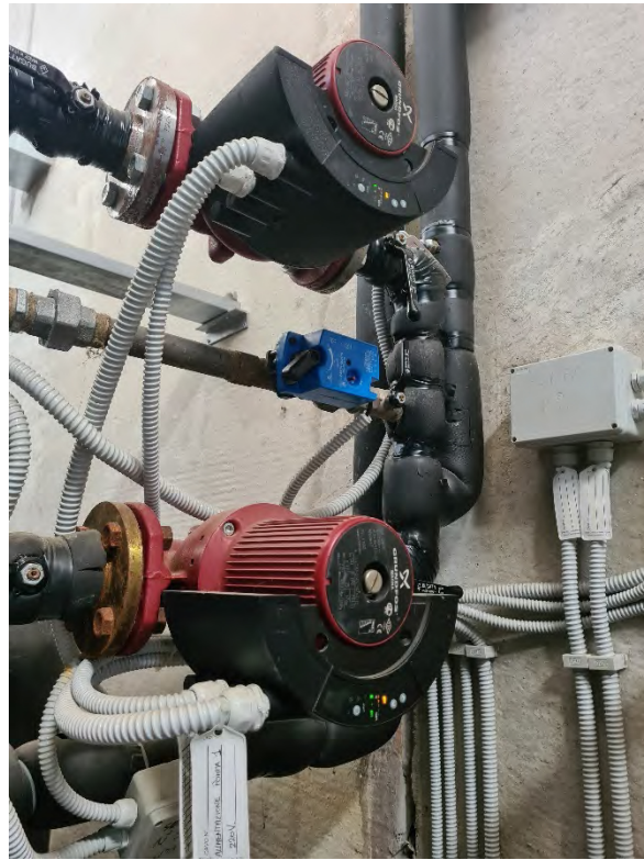
Figura 10: Pompa di circolazione Grundfos.
