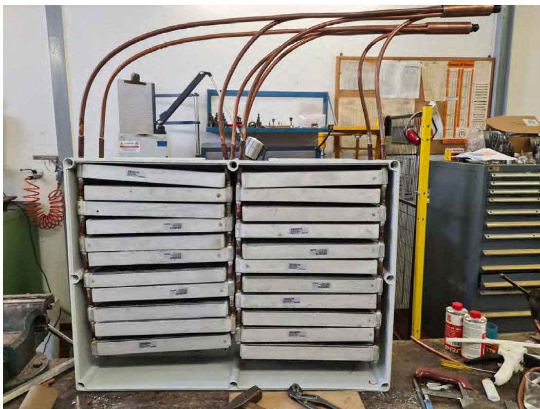
Figura 105 – Assemblaggio degli scambiatore all'interno del contenitore del PCM
