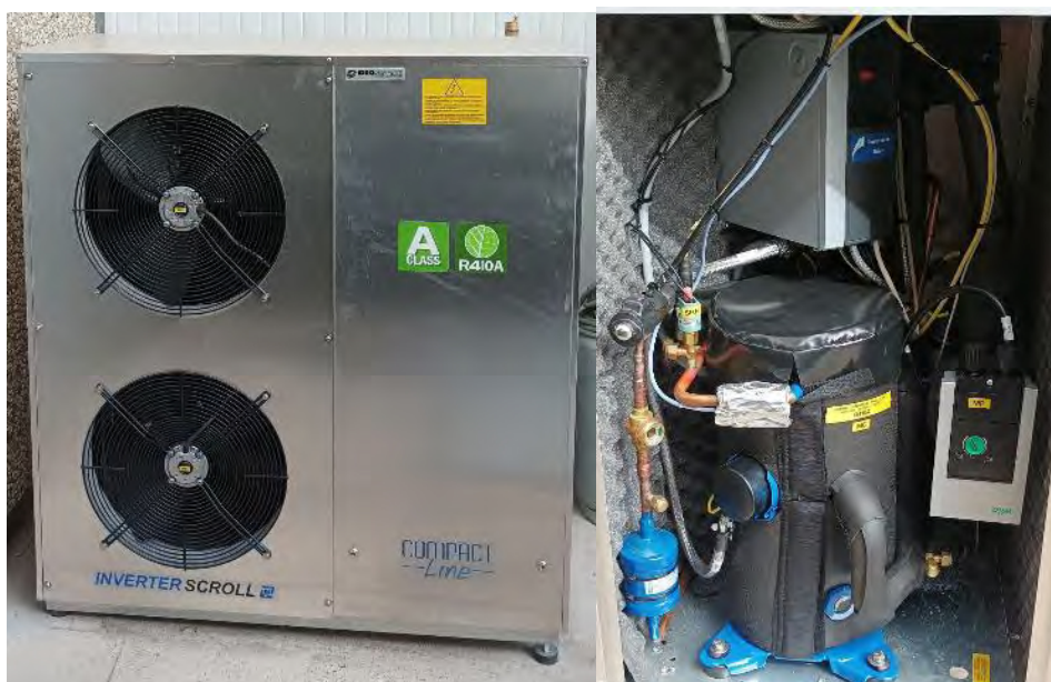
Figura 26. Chiller e pompa di circolazione integrata
