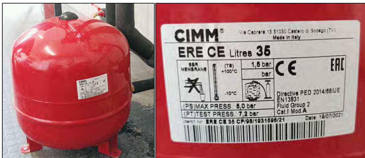
Figura 32. Vaso di espansione
