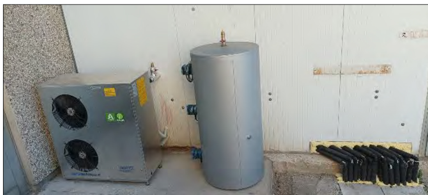
Figura 40. Chiller, serbatoio e collegamento delle sonde geotermiche ai due collettori
