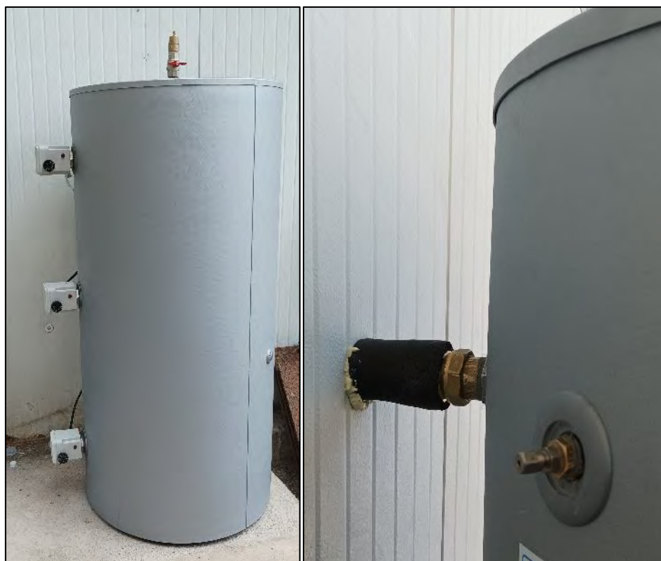
Figura 29. Serbatoio da 500 L installato
