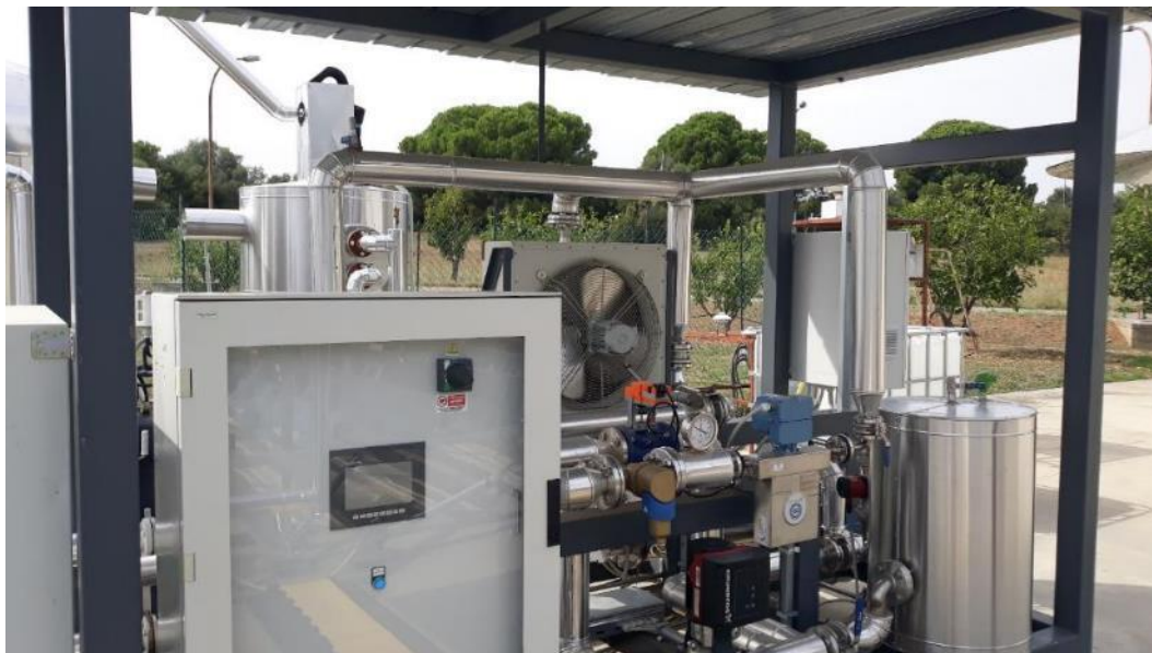
Figura 12 – Foto di dettaglio della skid utilizzata per la dissipazione del calore in regime controllato
