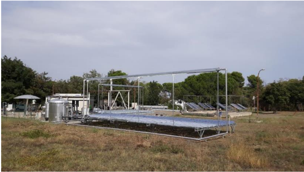
Figura 6 – Foto del campo solare Linear-Fresnel in esercizio
