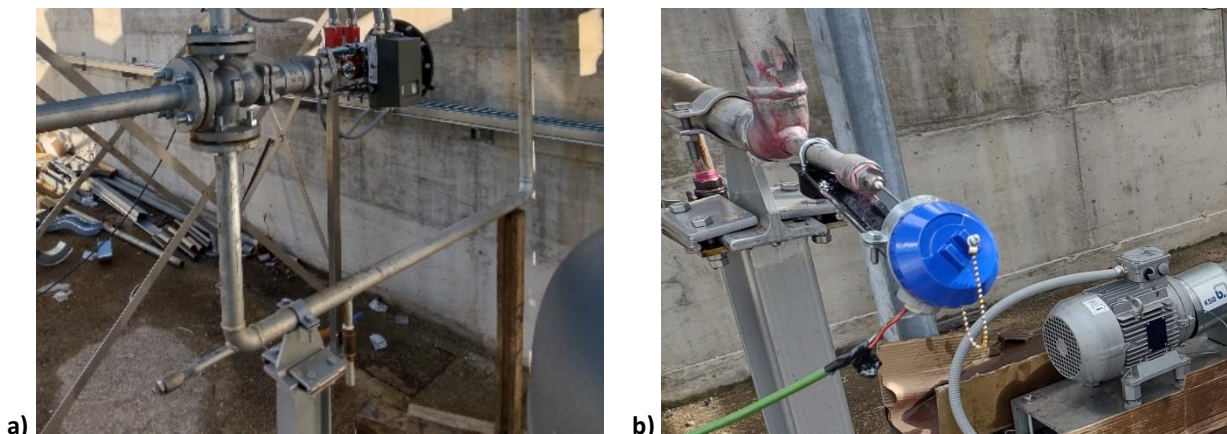
Figura 15. Punto di misura della temperatura del fluido termovettore in ingresso alla valvola a 3 vie RV.1C.01, prima di entrare negli aerotermini: a) pozzetto termometrico; b) termocoppia installata.
