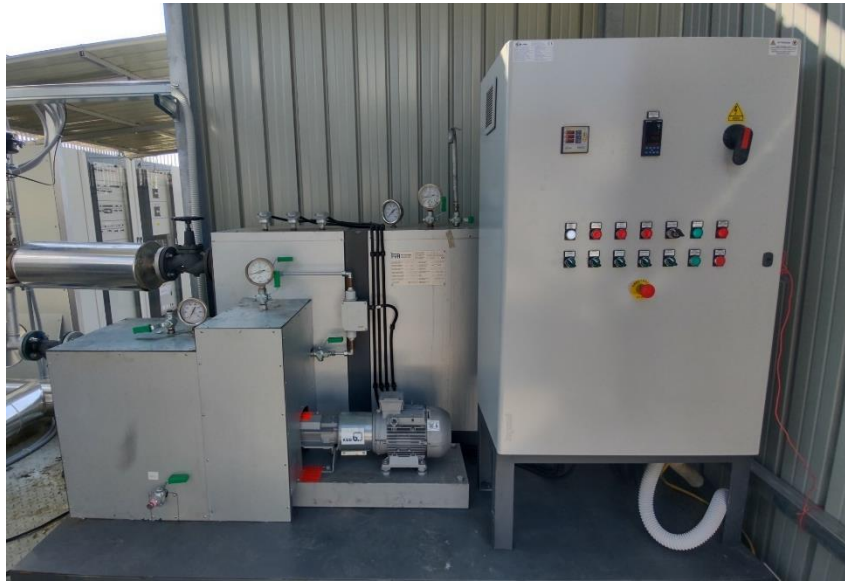
Figura 9. Riscaldatore elettrico per olio diatermico.
