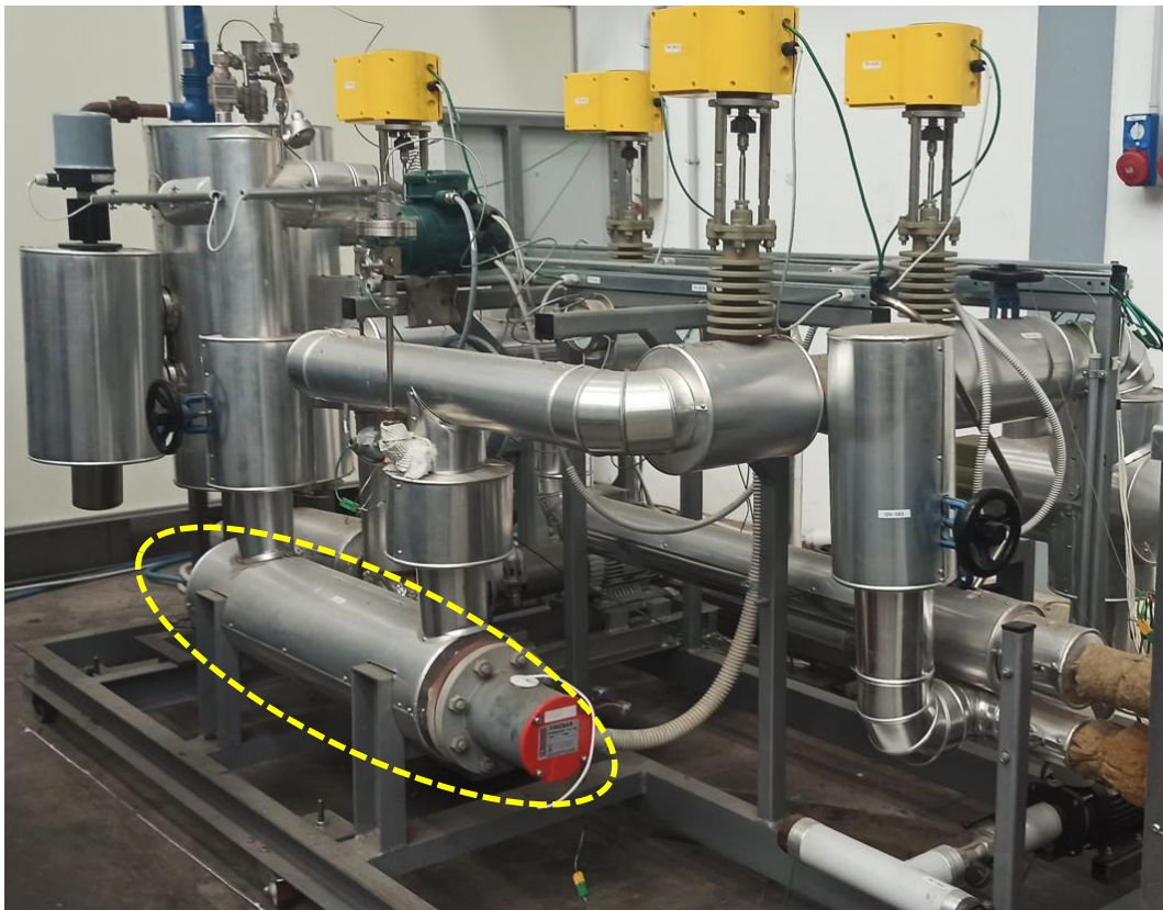
Figura 7-6: immagine dell'impianto con lo scambiatore/riscaldatore (evidenziato) nella posizione frontale.
