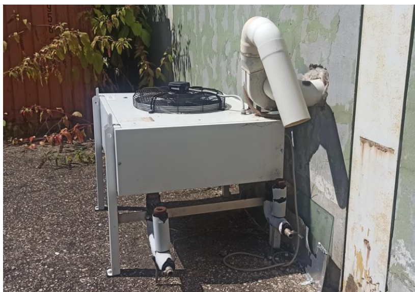
Figura 7-9: parte esterna dell'edificio, ove rimuovere raffreddatore già esistente e collegare il nuovo.
