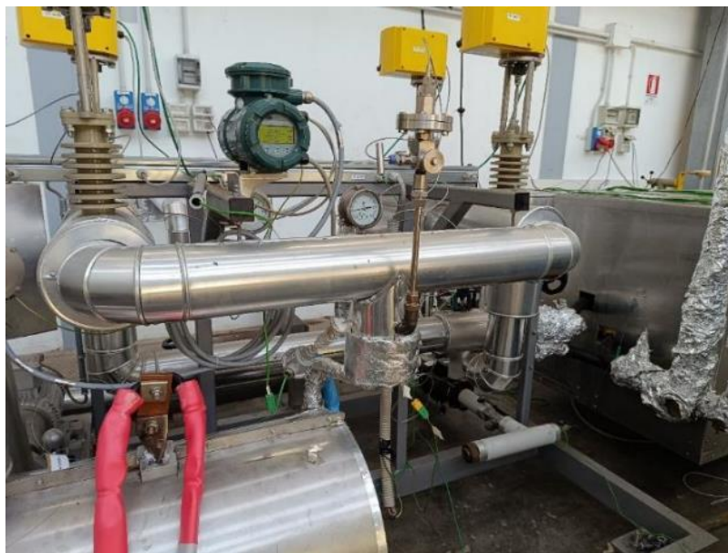
Figura 12: Particolare di due dei quattro morsetti per accoppiamento scambiatore/alimentatore e più in alto delle 4 valvole con attuatore elettrico.
