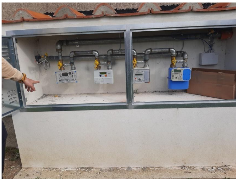
Figura 2 – Alloggiamento dei meter sotto test
