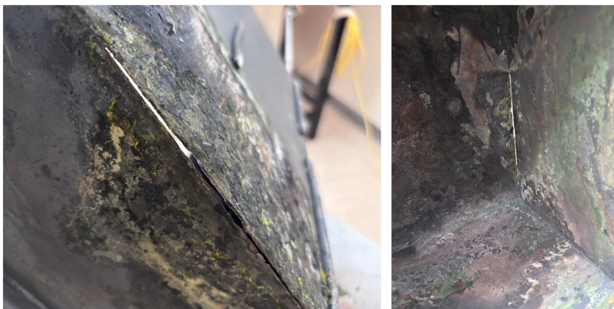
Figura 31 - Foto che evidenziano la fessurazione della storta a seguito di corrosione
