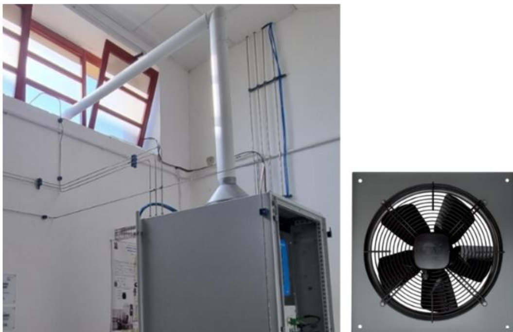
Figura 5.24 - Vista del tubo di ventilazione che convoglia all'esterno del laboratorio (a sinistra) e del ventilatore del sistema di estrazione (a destra).
