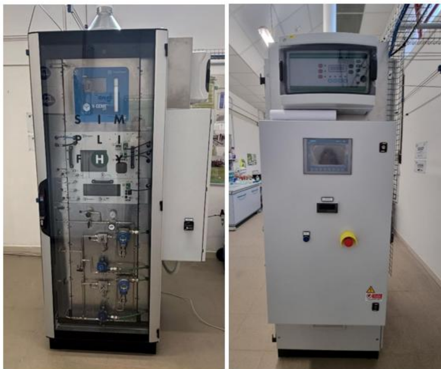
Figura 5.6 - Vista del cabinet di produzione di idrogeno: a sinistra gli elettrolizzatori e il pannello valvole, a destra il quadro elettrico dell'impianto, con l'HMI, la centralina di misura della conducibilità dell'acqua e i pulsanti di reset e di emergenza.
