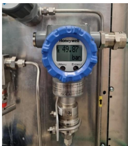
Figura 5.28 - Vista di un trasmettitore di pressione con manometro digitale integrato (PIT-002) durante il test di pressione
