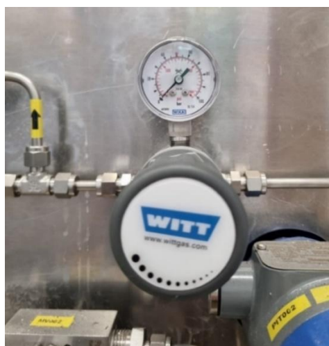
Figura 5.18 - Vista del riduttore di pressione con manometro (PCV-001).
