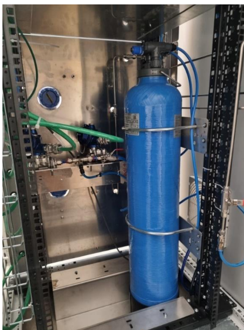
Figura 5.10 - Vista frontale del sistema di trattamento dell'acqua (WTS-001).
