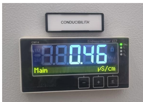
Figura 5.26 - Vista della centralina di misura della conducibilità dell'acqua, durante la fase di commissioning .
