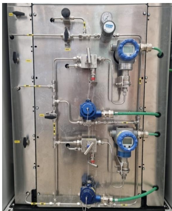
Figura 5.8 - Vista del costruttivo pannello valvole dell'impianto PtH.
