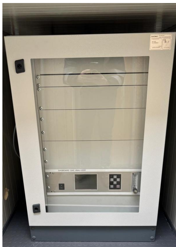
Figura 4.16 – Quadro elettrico dedicato all'alloggiamento dell'analizzatore online NDIR.
