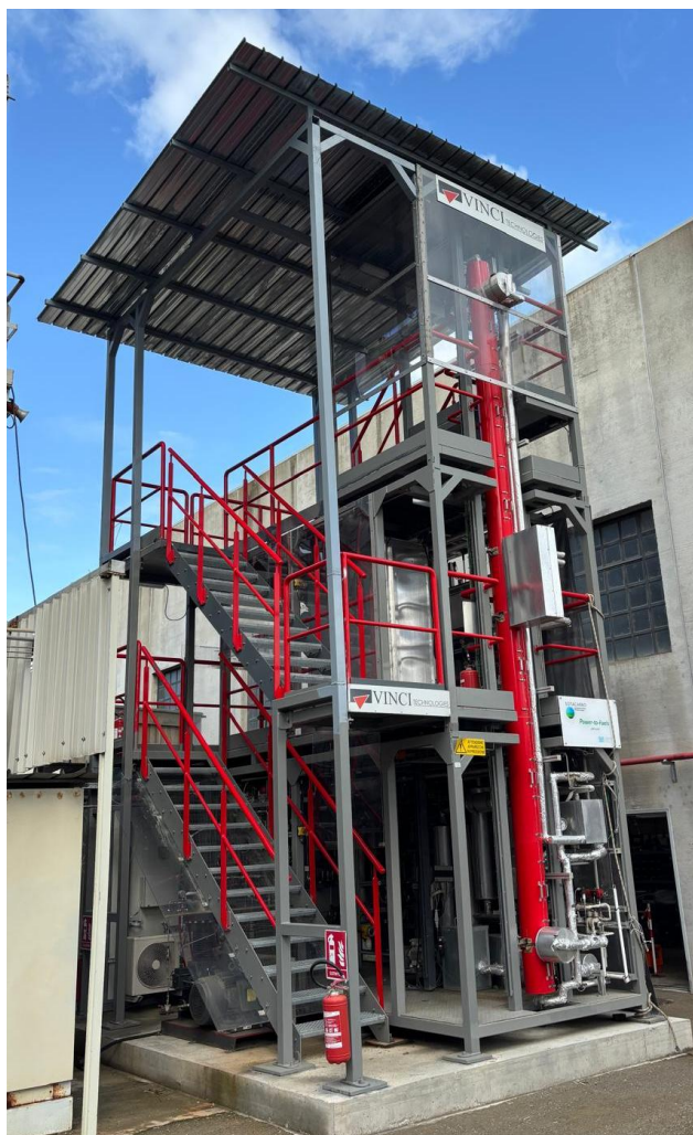
Figura 4.17 - Tettoia realizzata a protezione dell'impianto P2G/L.
