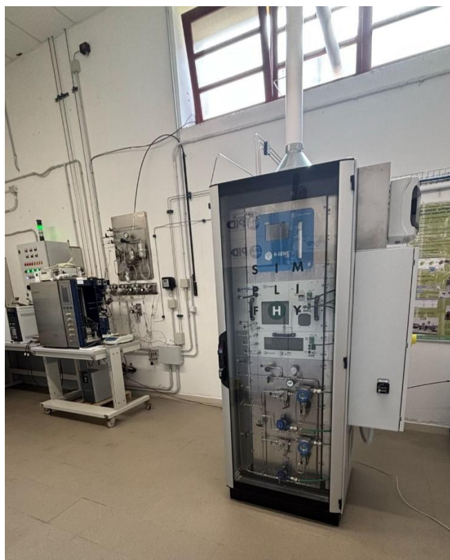
Figura 5.1 - Vista degli impianti del laboratorio dell'impianto " Carbon to new fuels ": in primo piano il PtH e, sulla sinistra, l'XtL.
