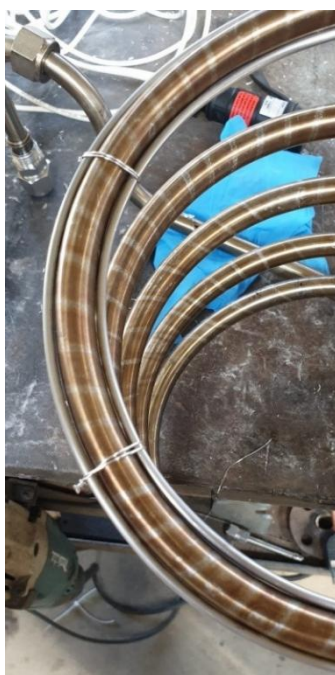
Figura 4.11 - Dettaglio della modalità di installazione tangenziale del cavo scaldante a isolamento minerale nella spirale.
