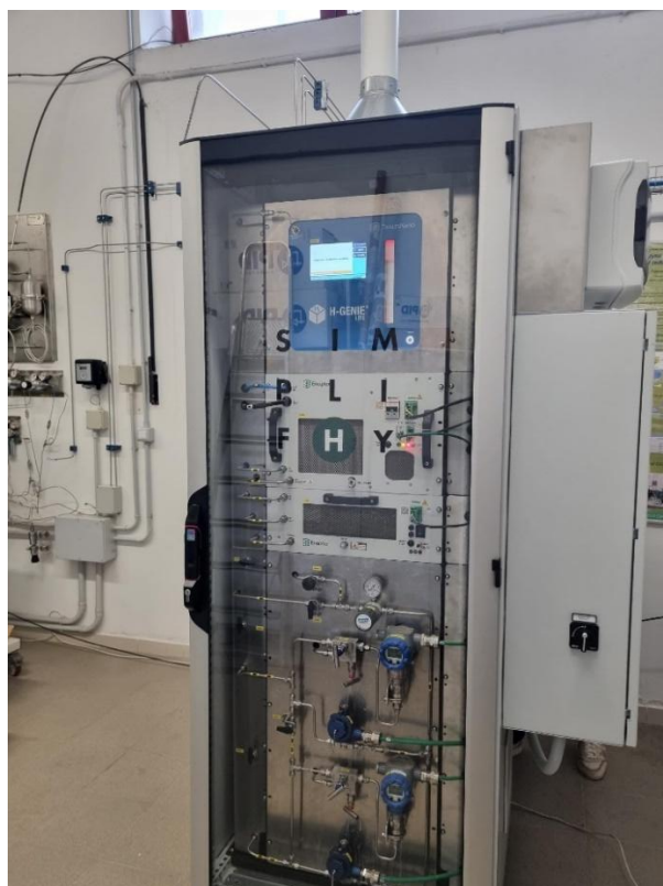
Figura 5.25 - Vista del cabinet PtH durante la fase di commissioning .
