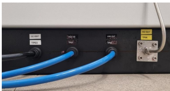
Figura 5.19 - Attacchi del cabinet per l'idrogeno in uscita (TP06, H 2 OUT), vent dell'ossigeno (TP03, O 2 VENT), acqua di rete in ingresso (TP01, H 2 O IN) e in uscita (TP02, H 2 O OUT).
