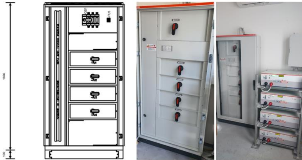
Figura 12: Quadro parallelo e sezionamento supercondensatori installato all'interno della cabina 3.
