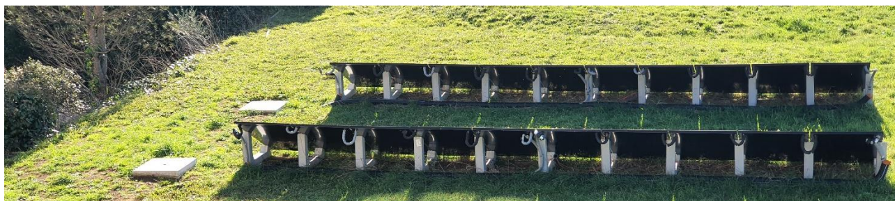
Figura 10: Impianto termofotovoltaico con nuovo layout di connessione e interrimento dei tubi con pozzetti di derivazione
