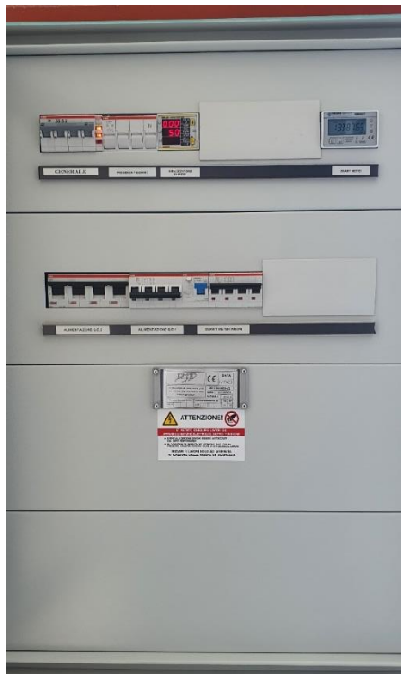
Figura 14: Quadro elettrico generale del sistema S.A.P.I.EN.T.E., QM, installato in Cabina 2.
