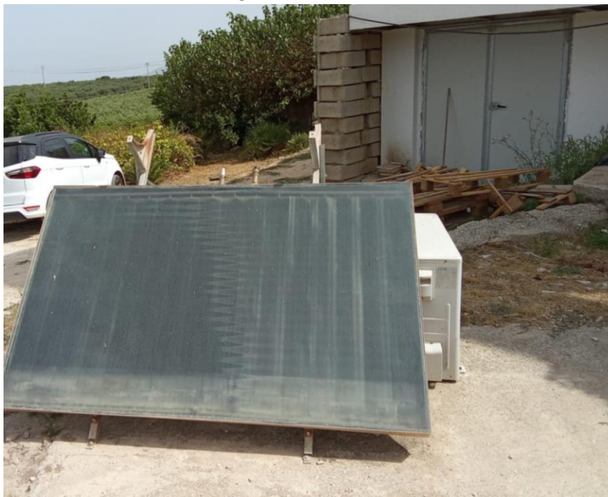
Figura 6. Impianto solare termico di recupero installato presso l'impianto sperimentale de i Nuovi Mille per il riscaldamento dei biodigestori
