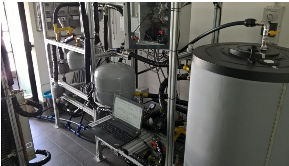
Figura 1. Impianto Prova Accumulo Termico.
