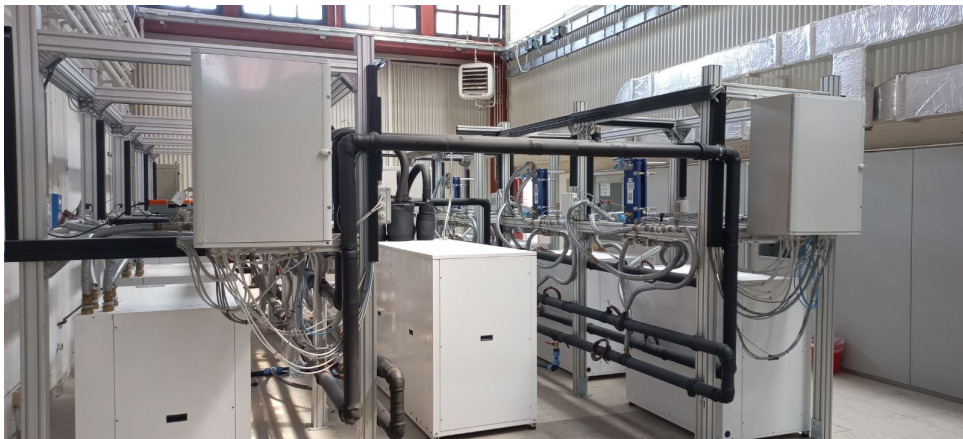
Figura 3. Rete termica a bassa temperatura presso ENEA Portici.
