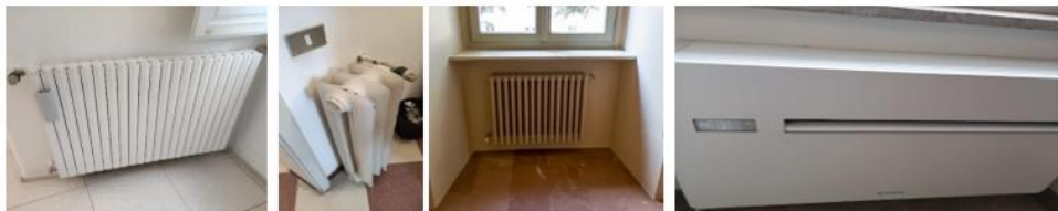
Figura 7.8 – Foto di alcuni radiatori e di una pompa di calore aria-aria presenti nell'edificio
