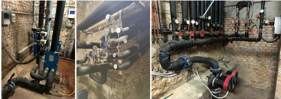
Figura 7.2 - Impianto previsto nella sottostazione del terzo seminterrato destinato all'alimentazione dei piani seminterrati (S1, S2, S3) e piano primo (P01)
