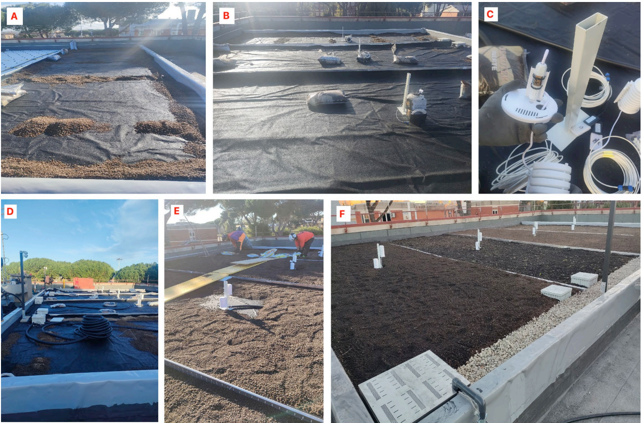
Figura 12 - Fotografie sul tetto durante il cantiere per l'installazione del sistema BGR. A) Applicazione del filtro in geotessuto (tessuto non tessuto) come strato di separazione tra il pannello ed il substrato. Il geotessuto, oltre ad impedire a piccoli frammenti di terriccio di penetrare nella stratigrafia sottostante, assorbe e trattiene sia l'acqua piovana che l'acqua d'irrigazione proveniente dal bacino secondario. B) Il geotessuto viene disposto sulle 4 parcelle del campo prova; in seguito, al centro di ogni parcella, viene collocata una colonnina metallica per l'ancoraggio della sensoristica (temperatura e umidità del suolo e dell'aria, ovvero T1, U1, T2, U2, T3, U3, T4, U4; vedi Fig. 31). C) Particolare della sensoristica, sono visibili le custodie protettive dei sensori per la temperatura e umidità dell'aria e i due sensori per la temperatura e l'umidità del suolo con la sonda ancora coperta, che andranno collocati a diverse altezze a partire dalla base di geotessuto. D) Le videocamere sono state posizionate, una a cavallo delle parcelle P1 e P2, l'altra a cavallo delle parcelle P3 e P4; attraverso i tubi corrugati neri verranno fatti passare i cavi elettrici di collegamento con la centralina del sistema e alla presa elettrica. E) Aggiunta del substrato posato sopra il geotessuto; F) il substrato è stato posato nello spessore stabilito (8 cm per il Sedum in P2 e P4; 12 cm per il prato fiorito in P1 e P3) e miscelato al Biochar in P1 e P3; in P2 e P4 il Sedum è stato già messo a dimora per spargimento di talee.
