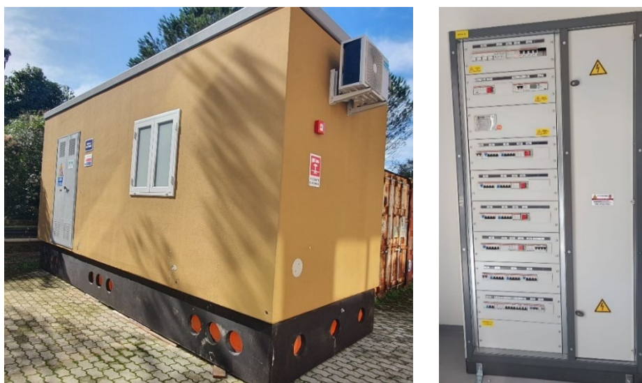
Figura 5 - Esterni della nuova cabina installata presso il C.R. Casaccia e relativo quadro elettrico.
