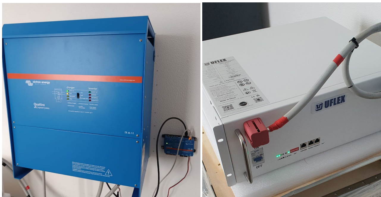
Figura 7 - Inverter caricabatterie e supercondensatori installati all'interno della nuova cabina installata presso il C.R. Casaccia.
