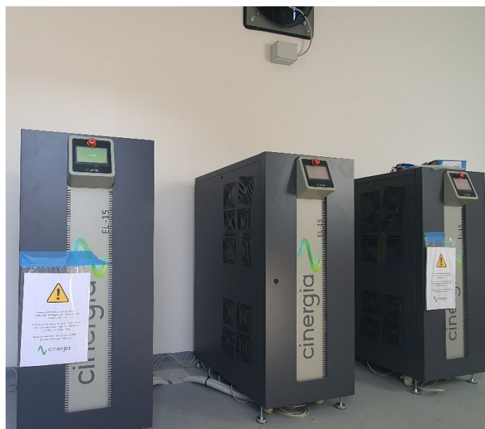
Figura 6 - Carichi elettronici posti in opera all'interno della nuova cabina installata presso il C.R. Casaccia.
