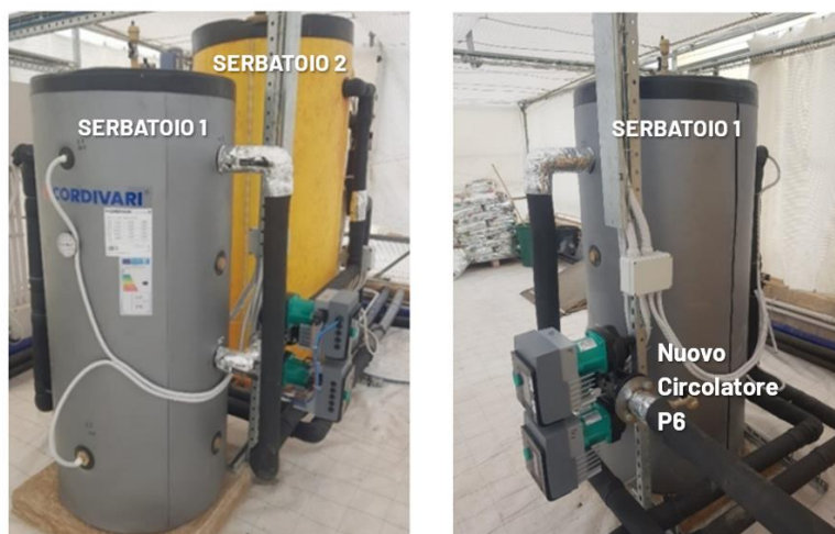
Figura 4 - Serbatoio 1 "Aermec" e nuovo circolatore "P6"
