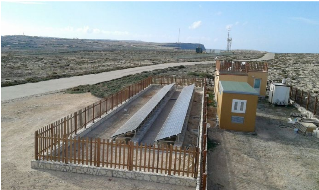
Figura 9. Impianto PV (14,2 kWp) con accumulo di Lampedusa.
