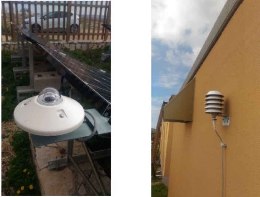
Figura 10. Sensori di radiazione solare e di temperatura ambiente.
