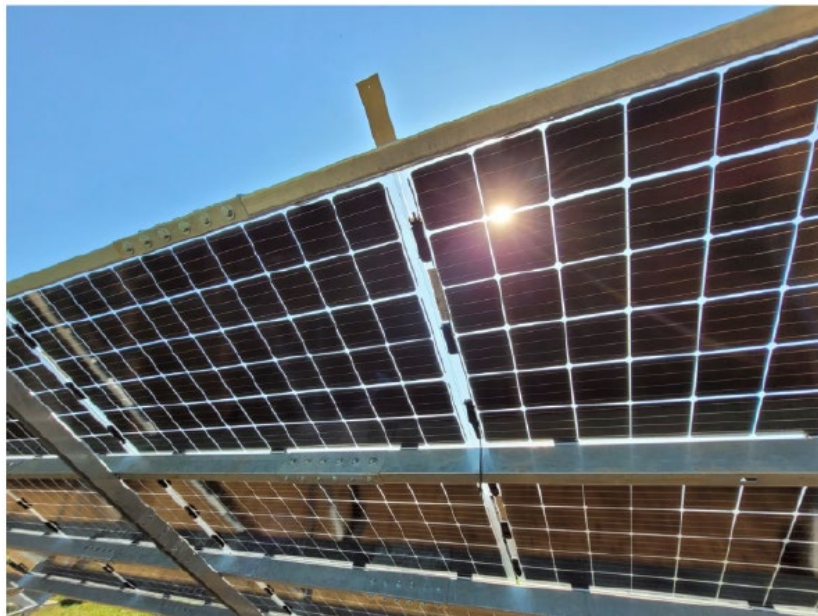
Figura 13. Impianto PV F50.
