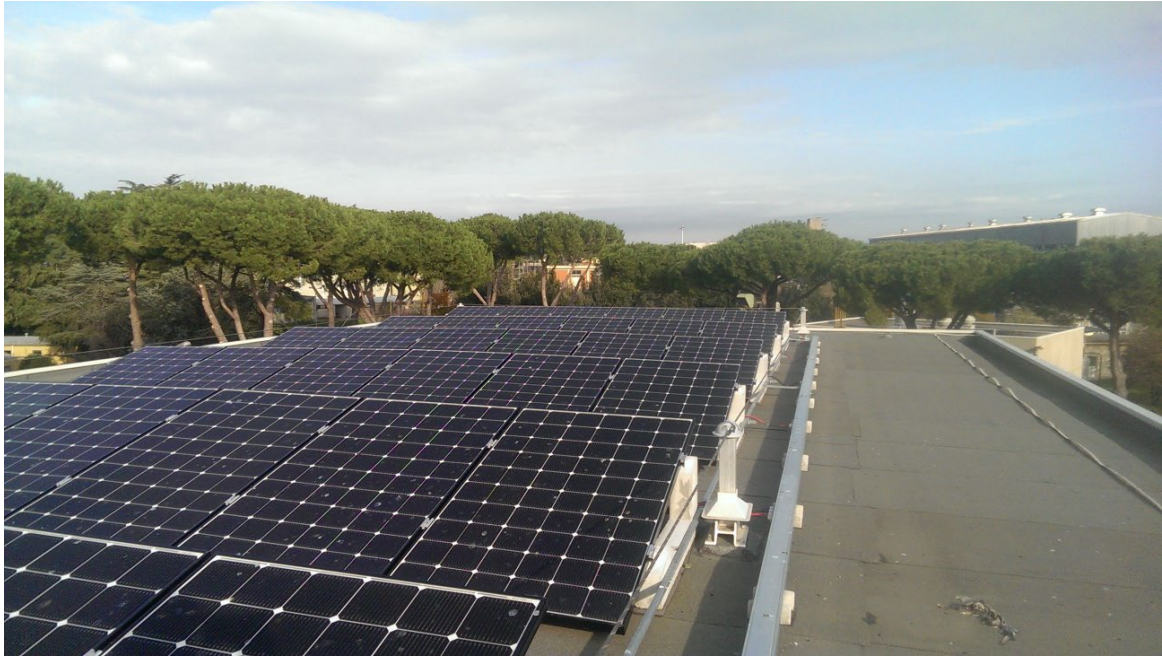
Figura 1. Generatore fotovoltaico installato sulla copertura dell'edificio F40.
