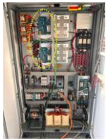
Inverter stazione di ricarica
