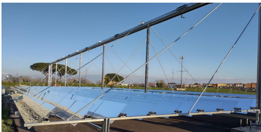
Figura 1 – Campo solare dell'impianto CSP “ENEASHIP”
