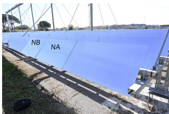
Figura 6 - Specchi installati in campo nell'area nord.
