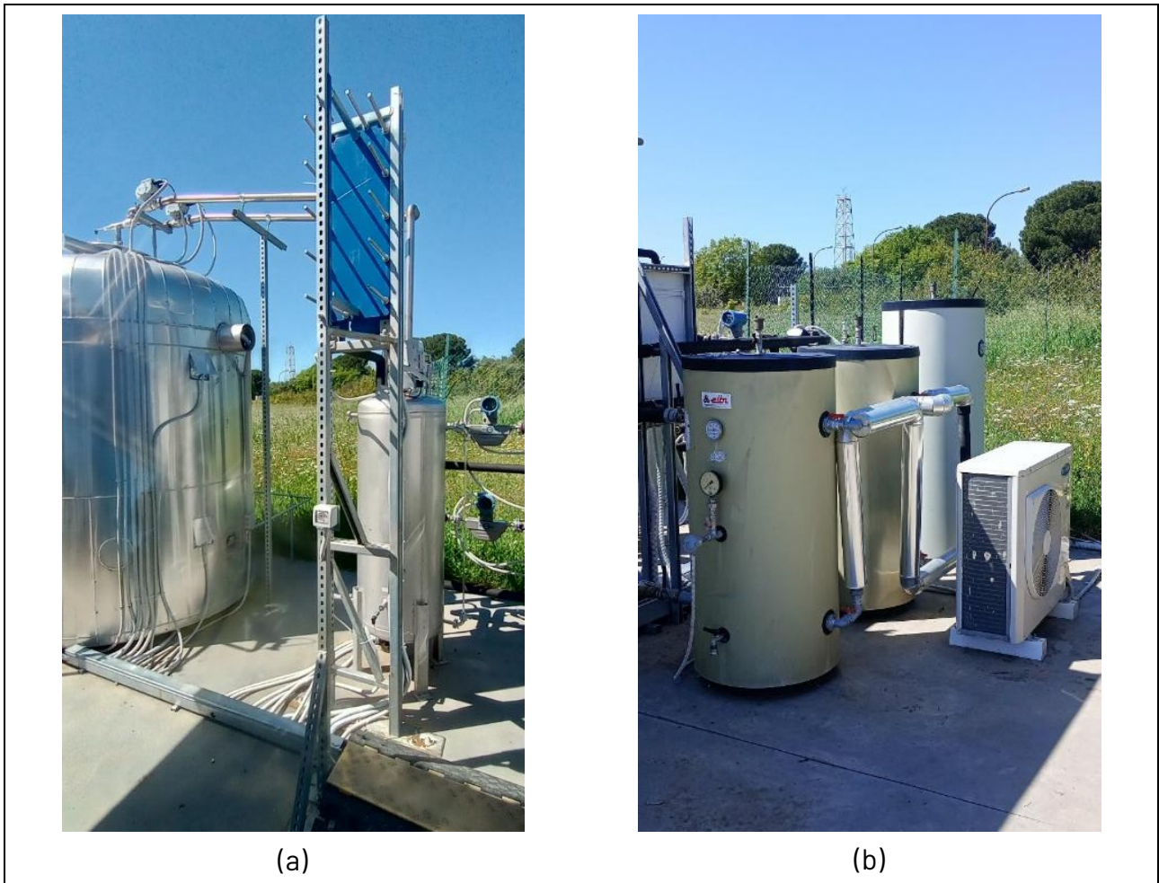
Figura 10 - Elementi realizzati nella fase di up-grade: (a) circuito sottovuoto con unità di condensazione-evaporazione; (b) circuito termo-idraulico ad acqua a servizio dell'unità di condensazione-evaporazione
