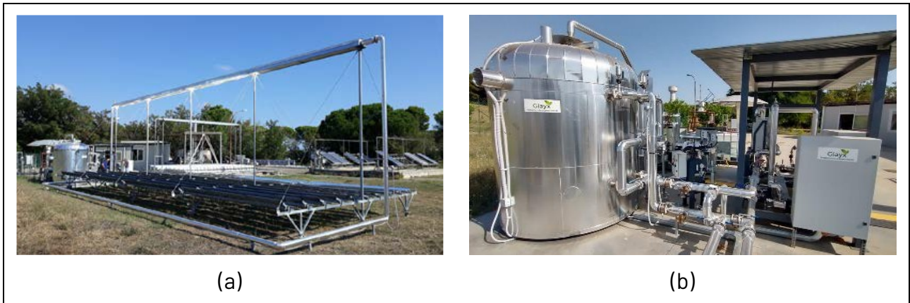
Figura 7 – Impianto SUNSTORE: (a) campo solare Liner Fresnel; (b) reattore connesso alle utility di supporto (phase-changer) e all'unità di dissipazione del calore ad acqua pressurizzata
