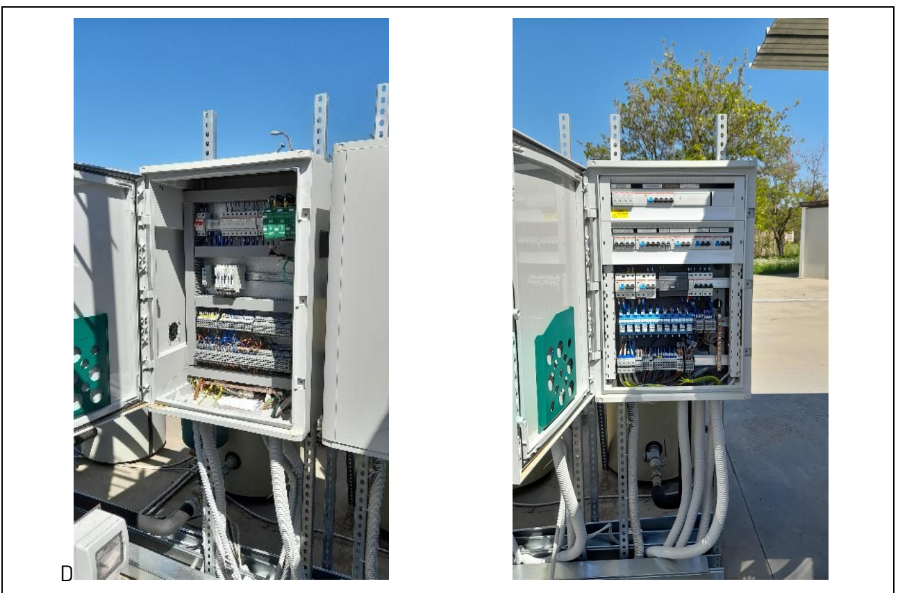
Figura 21 - Up-grade facility Sunstore - dettagli dei nuovi quadri di alimentazione (a destra) e controllo (a sinistra)
