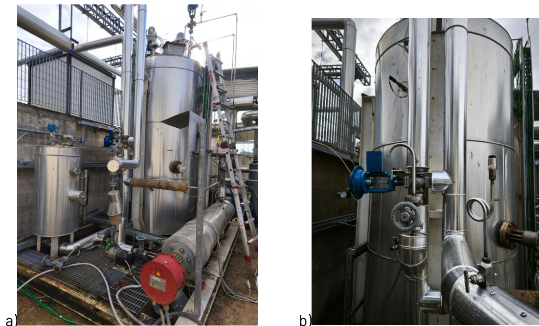
Figura 7 – a) vista del serbatoio di stoccaggio, vaso di espansione, pompa di circolazione e riscaldatore, b) vista generale serbatoio
