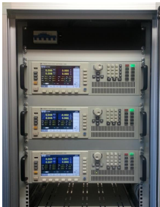
Figura 58: Installazione dei carichi elettronici DC/AC
