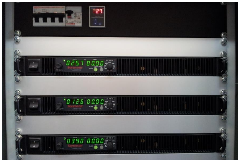
Figura 56: Alimentatori elettronici con particolare del termostato e degli interruttori di protezione
