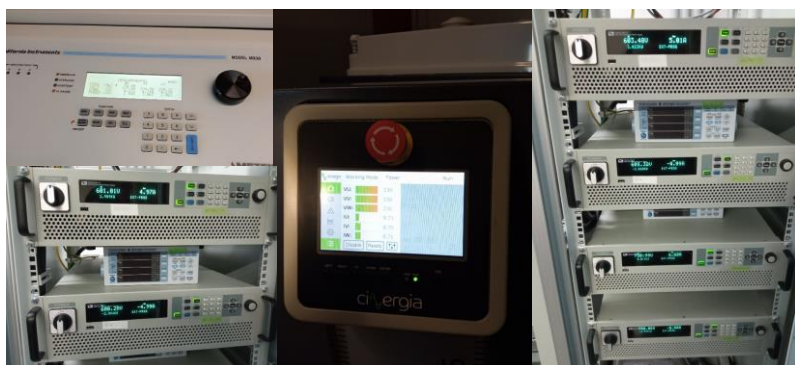
Figura 7: Apparecchiature di generazione/accumulo e carico utilizzate per la validazione sperimentale
