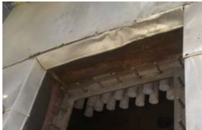
Figura 3. Dettaglio sul sistema a candele ceramiche per alta temperatura per filtrazione del gas prodotto, integrato nel freeboard del reattore di gassificazione ICBBF 1000 kW t
