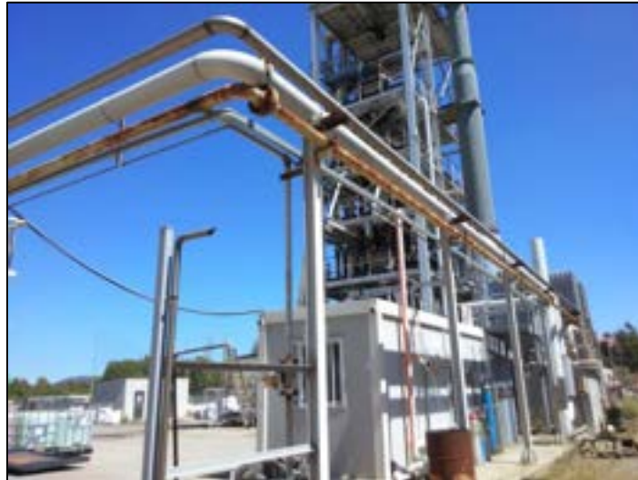
Figura 39. Linea di collegamento syngas tra gli impianti Dimostrativo e Pilota
