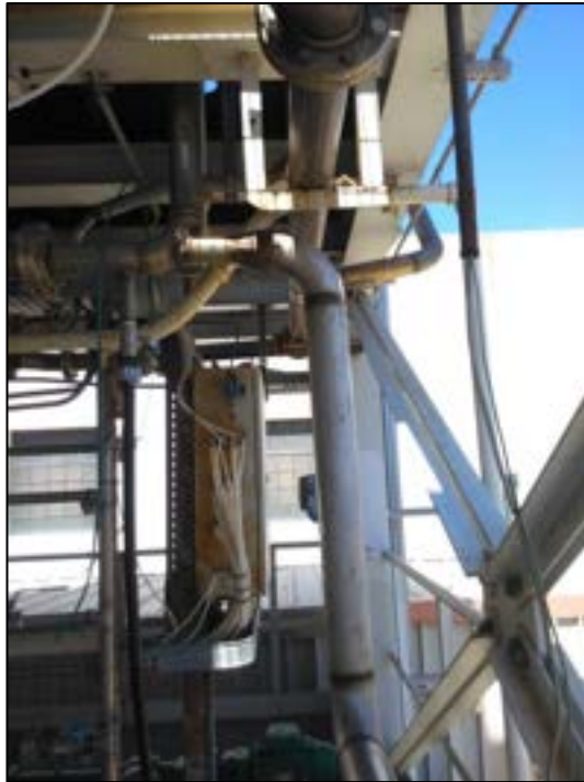
Figura 41. Punto di immissione del syngas a valle dello skid dell'Impianto Pilota
