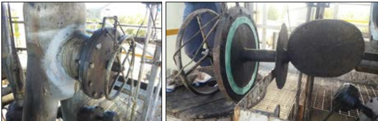
Figura 17. A - Bocchello di ispezione con sistema rompiponte, B – Sistema interno con paletta rompiponte
