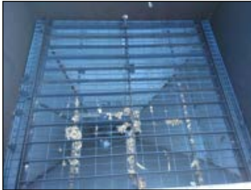
Figura 10. Griglia interna per vagliatura del combustibile in tramoggia
