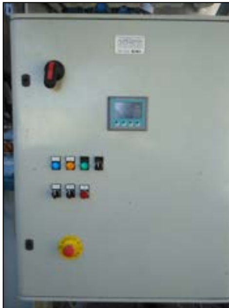
Figura 8. Quadro di controllo Redler.
