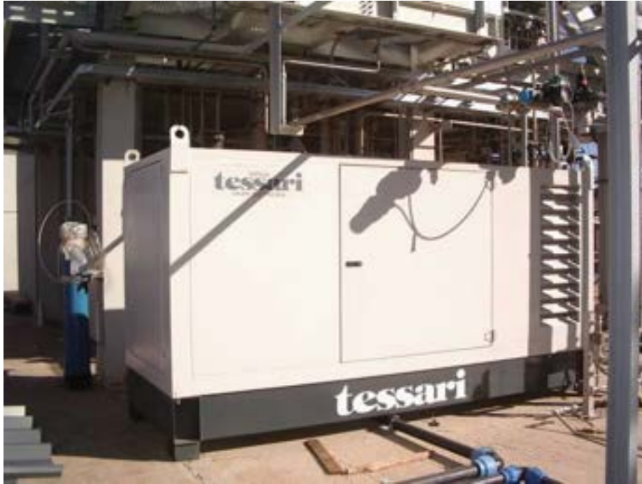
Figura 43. Gruppo elettrogeno Tessari da 24 kW elettrici
