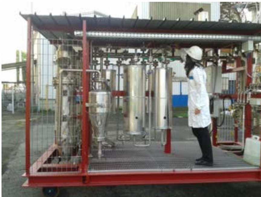
Figura 3. Impianto di produzione di gas sintetico GESSICA
