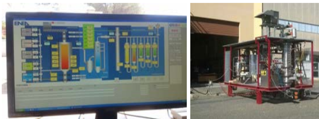
Figura 15. Sinottico durante un test e vista lato gassificatore dell'impianto
