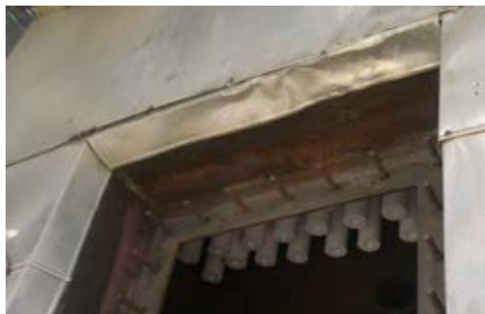
Figura 2. Dettaglio sul sistema a candele ceramiche per alta temperatura per filtrazione in-single-vessel del gas prodotto, integrato nel freeboard del reattore di gassificazione ICBFB 1000 kW t
