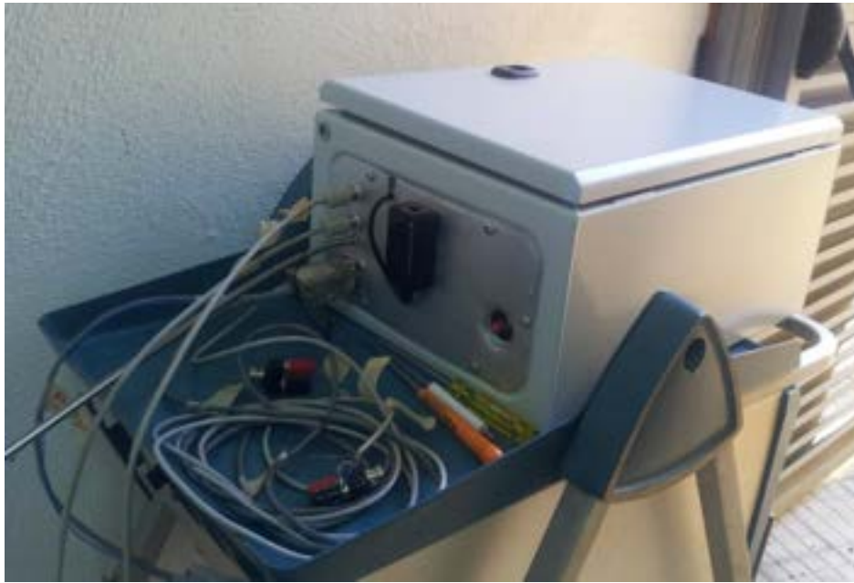
Fig. 4: Contenitore ATEX all'interno del quale è posizionato il sistema ODC con la ruota porta-filtri.
