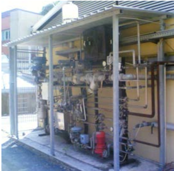
Fig. 13: Skid di controllo e regolazione dell'aria comburente e del gas naturale.
