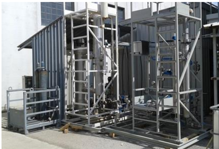
Figura 6. Impianto di assorbimento CO 2 e rigenerazione MEA
