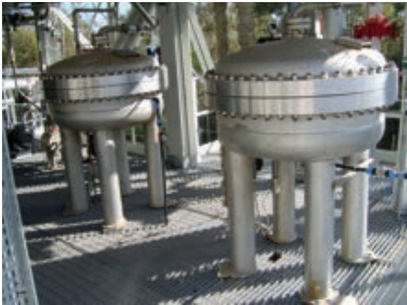
Dettaglio separatori CO 2
