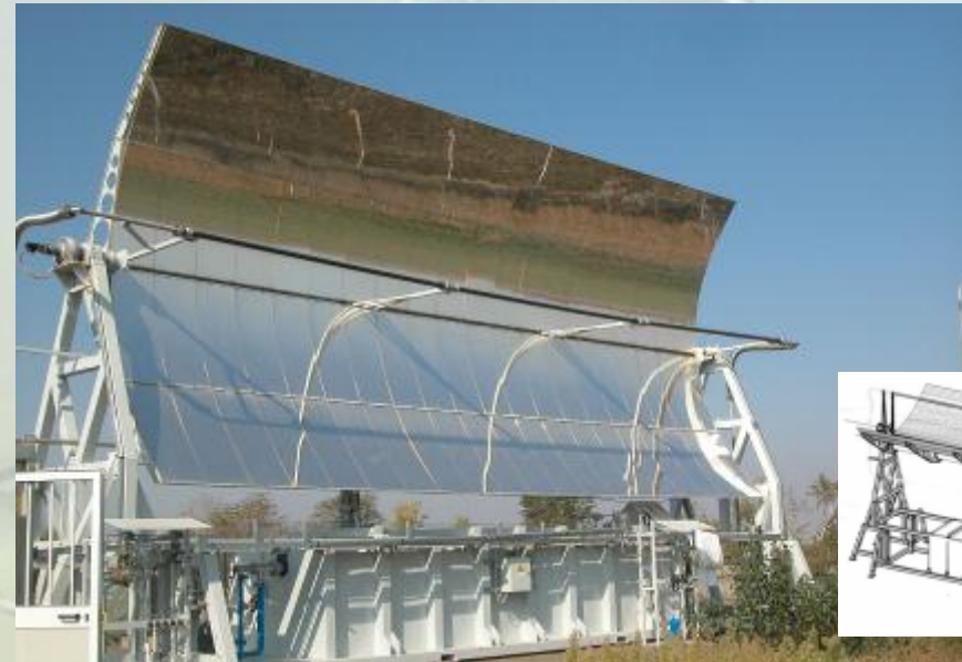
Impianto solare presso FN Bosco Marengo
