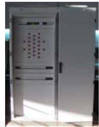
Quadro di controllo
