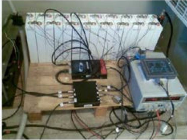
BMS n. 1 (di tipo passivo) in esercizio
