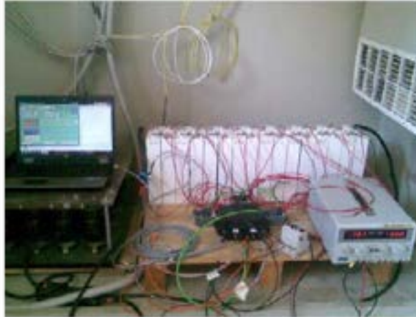
BMS n. 2 (di tipo semiattivo) in esercizio
