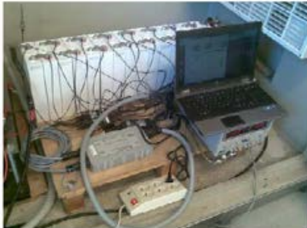
BMS n. 3 (di tipo passivo) in esercizio
