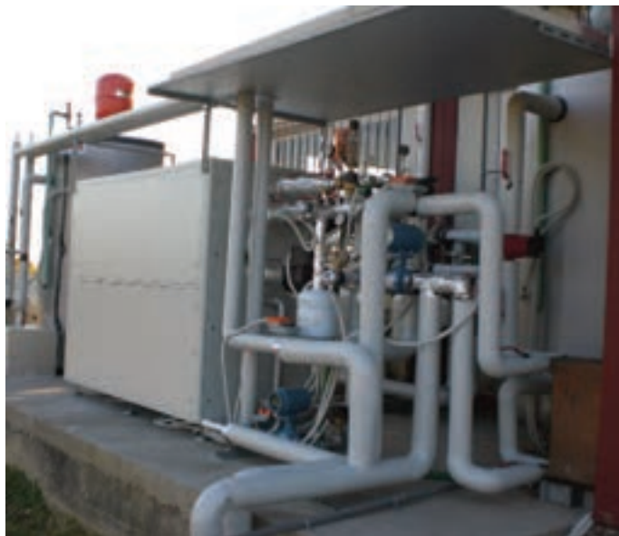
Facility di test pompa di calore a CO 2 (R744)
