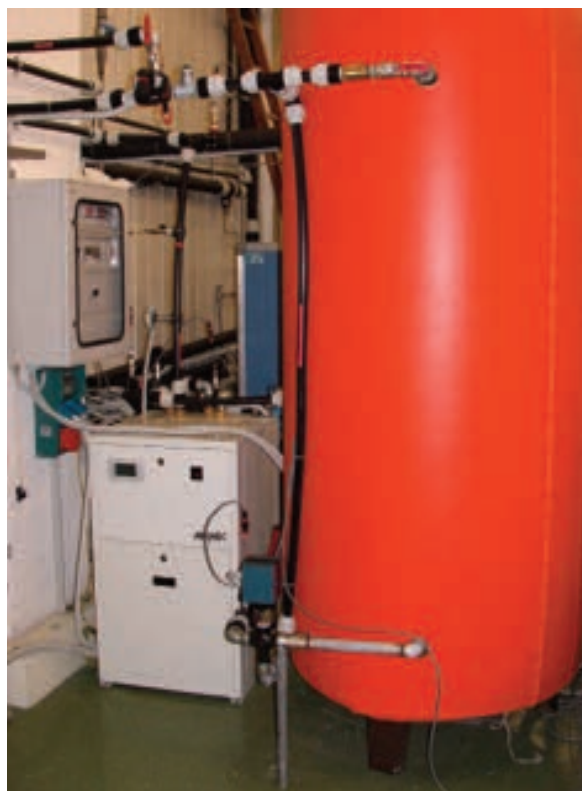
Facility di test per pompe di calore elioassistite
