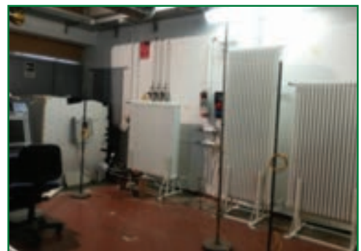
Facility di prova con pompa di calore a CO 2 abbinata a radiatori a elevato salto termico
