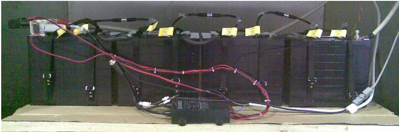
Sistema di accumulo 200 Ah/48 V adatto a diverse esigenze di trazione elettrica in fase di test
