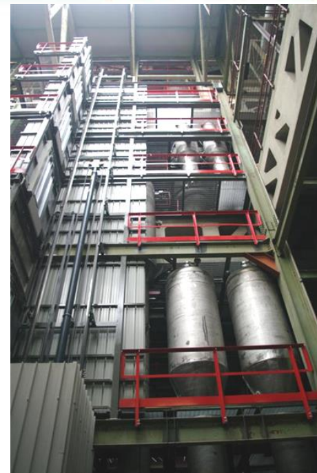
Serbatoi del contenimento SPES-3 installati sulla struttura
