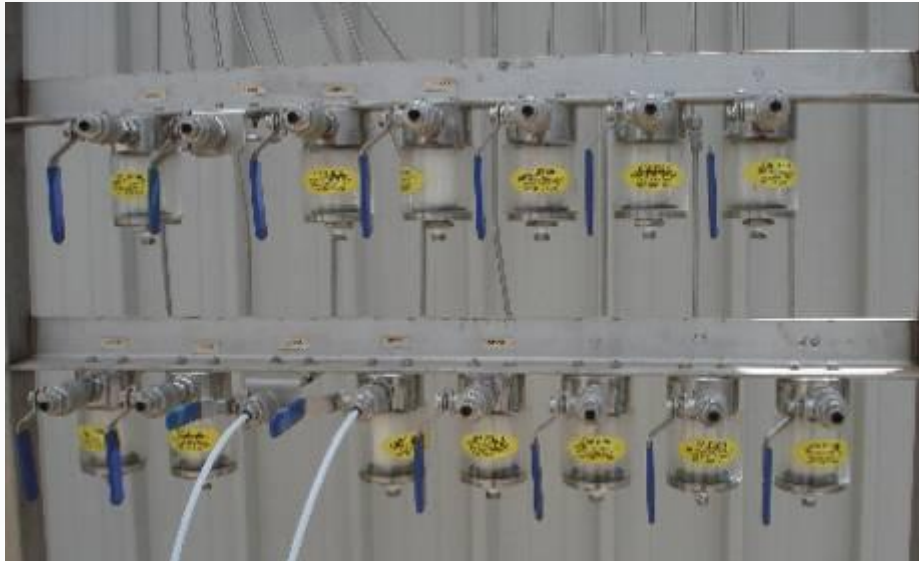
15 prese di campionamento impianto pilota
